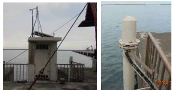
圖4 花蓮潮位站現場站房(左)及其靜水井(右)
